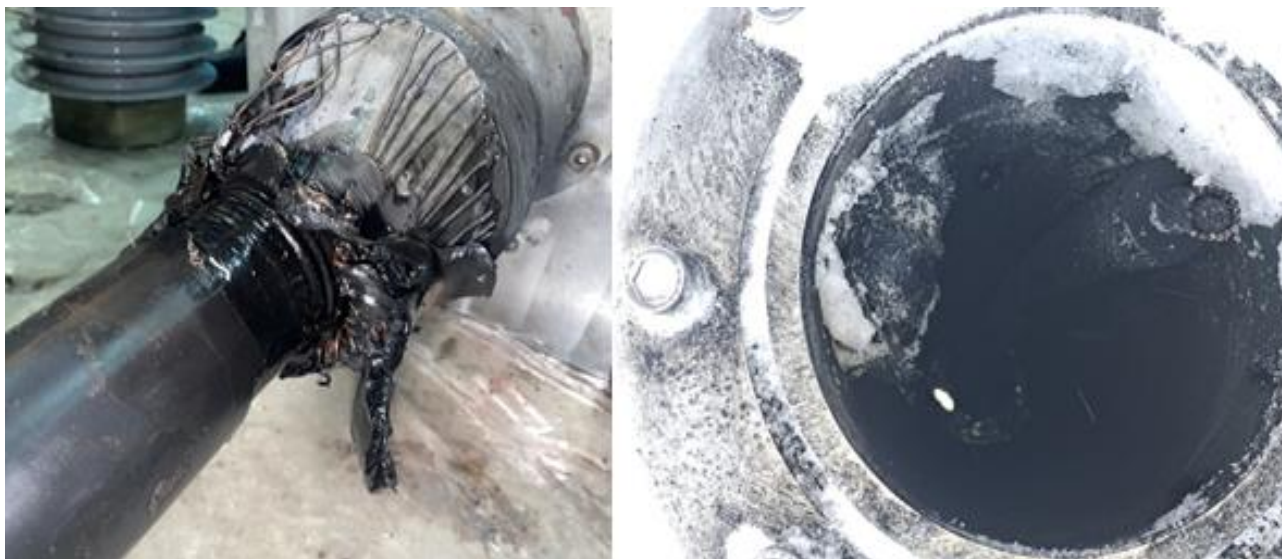
Рис. 2. Поврежденная кабельная система 110 кВ после эксплуатации при -55^{\circ}\text{C} (слева – следы повреждения экрана, изоляции и оболочки кабеля, справа – поврежденная муфта изнутри)
